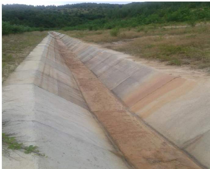
Fig. 2.7. Sistem de captare a apelor de șiroire, constând din șanțuri betonate de captare
