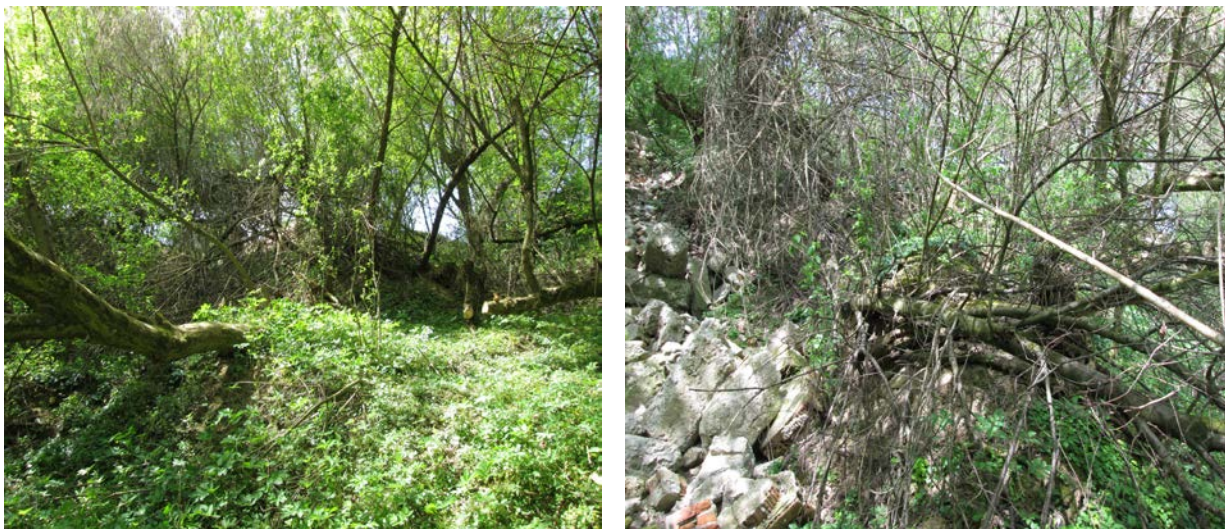
Figura 3.32, 3.33 – Alunecare de teren pe malul stâng al pârâului Saeș
