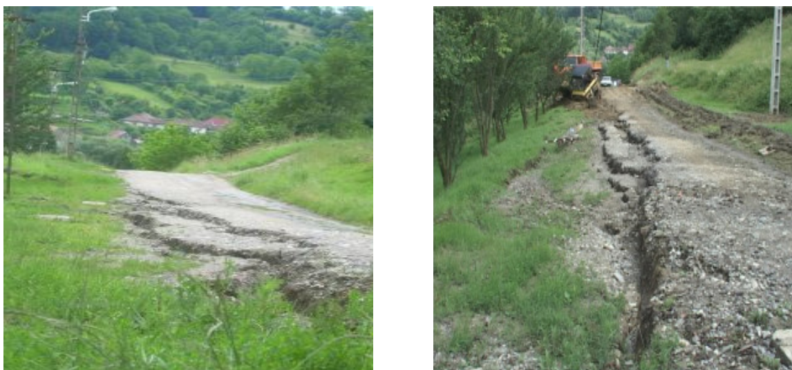
Figura 3.34, 3.35 – Alunecare de teren pe malul stâng al pârâului Saeș care a afectat strada Vasile Lucaci
