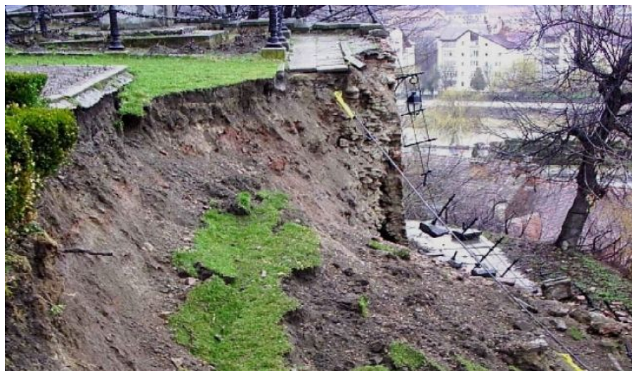
Figura 3.25 – Alunecare de teren pe versantul estic al Dealului Cetății care a afectat zidul cetății
