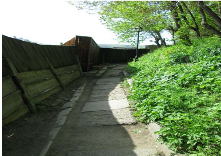
Figura 3.21 – Alunecare de teren pe versantul sud-estic al Dealului Cetății
