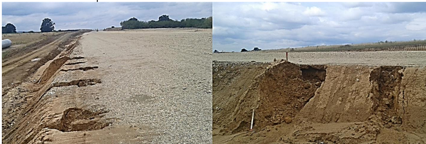
Foto. 1 – Exemple de ramblee deteriorate
